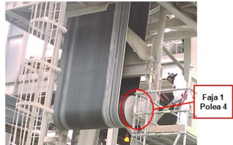
Mancais do contrapeso da esteira 1
